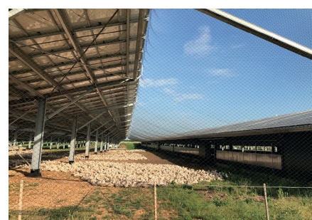
4 – Volière photovoltaïque de Rom (79) © Technique Solaire
